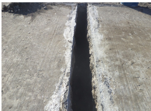
Рис. 1. Уширение шва с разрушением герметика.
