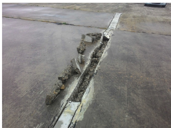
Рис. 2. Разрушение ремонтного материала при уширении шва.
