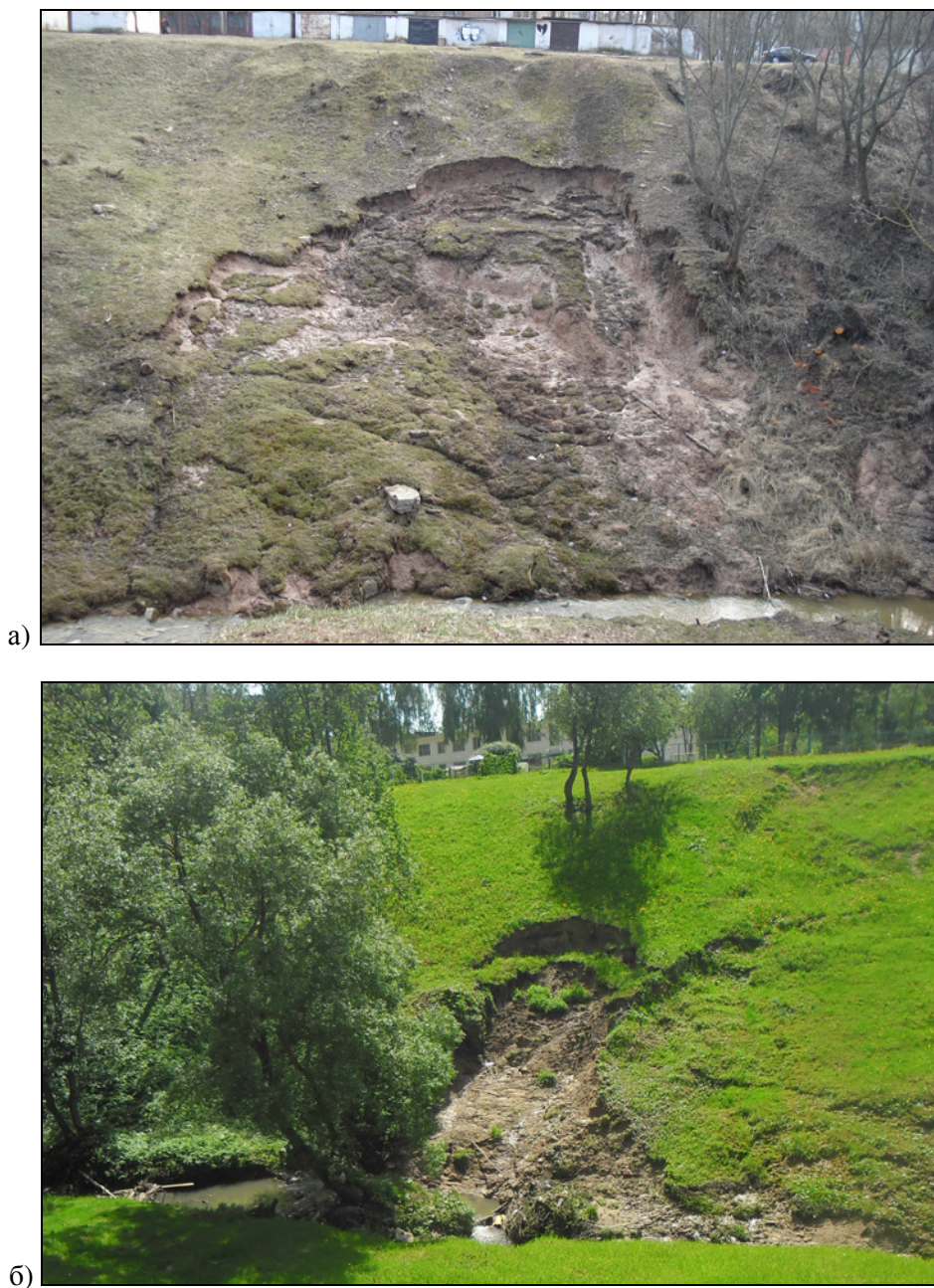
Рис.3. Участок левого склона оврага Гапеевский вблизи мостового перехода: а – слева от моста (апрель, 2008 г.), б – справа от моста (май, 2013 г.).
