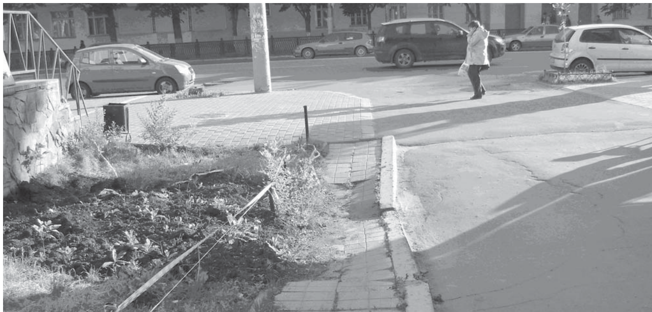
Рис. 1. Провал вблизи дома с пристройкой по ул. Плехановская
