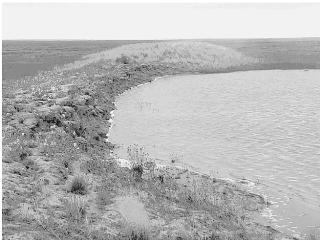
Рис. 3. Автодорога Промбаза ГП-1 — ГП-1. Откосы подвержены термокарстово-абразионным процессам. На локальном участке насыпь частично сплыла в термокарстовое понижение.
