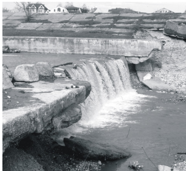
Рис. 5. Полуразрушенный перепад. Фото автора
