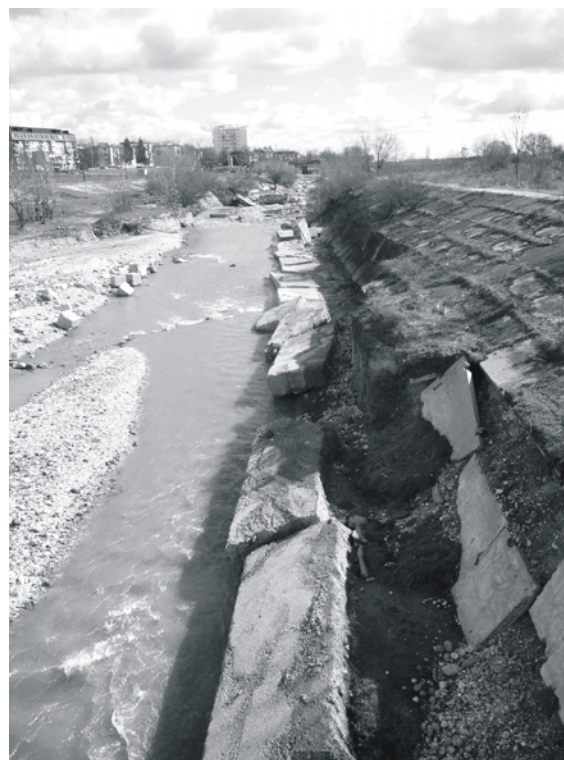
Рис. 3. Линейное обрушение подпор на правом берегу Нальчика. Фото автора
