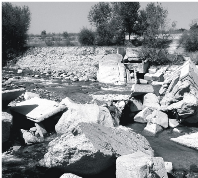
Рис. 4. Разрушенный поперечный уступ. Фото автора
