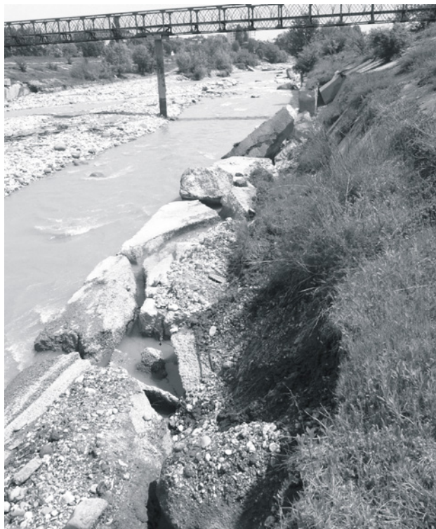
Рис. 2. Обрушение подпор. Фото автора
